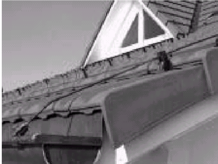
Bild 1: Der äussere Blitzschutz besteht aus Fangleitungen auf dem Gebäudedach...
